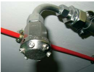
Hochdrucklöschanlage in den Katakomben des Sperrwerks
