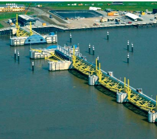
Ems-Sperrwerk: In natura
